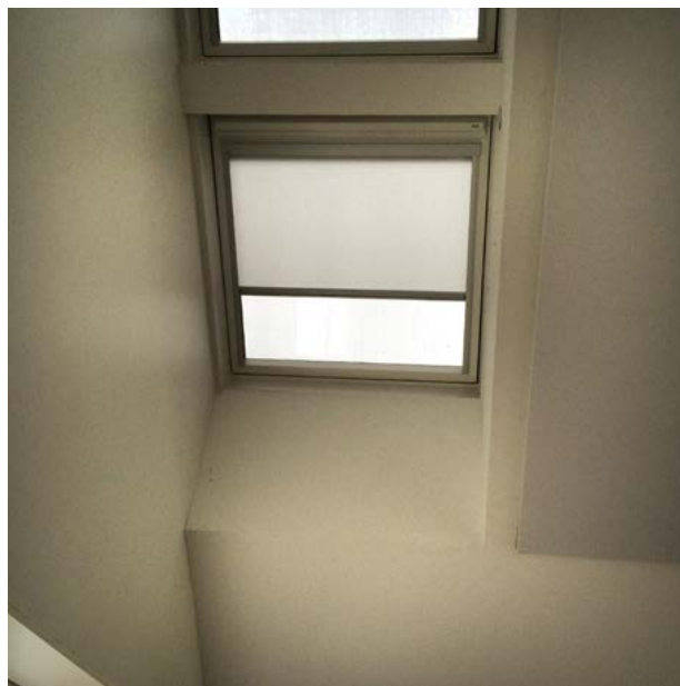
Vippevindue i tag til afkast af luft
