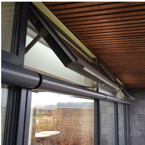
Tophængslet vindue i facade til indtag af luft
