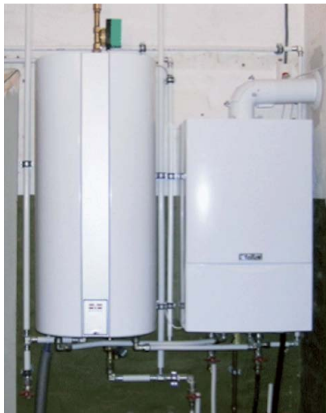
Ny varmtvandsbeholder med ny gaskedel
